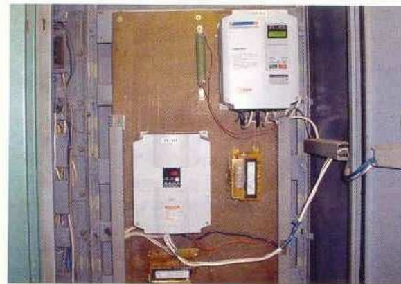
Шкаф управления приводами подачи сухой стружки с преобразователями EI-8001
