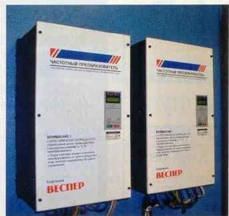
Преобразователи частоты EI-7011 приводов вентиляторов системы аспирации
